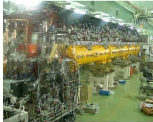
図 4: KEK でのビーム試験のために装着された DTL 第 1 タンク
